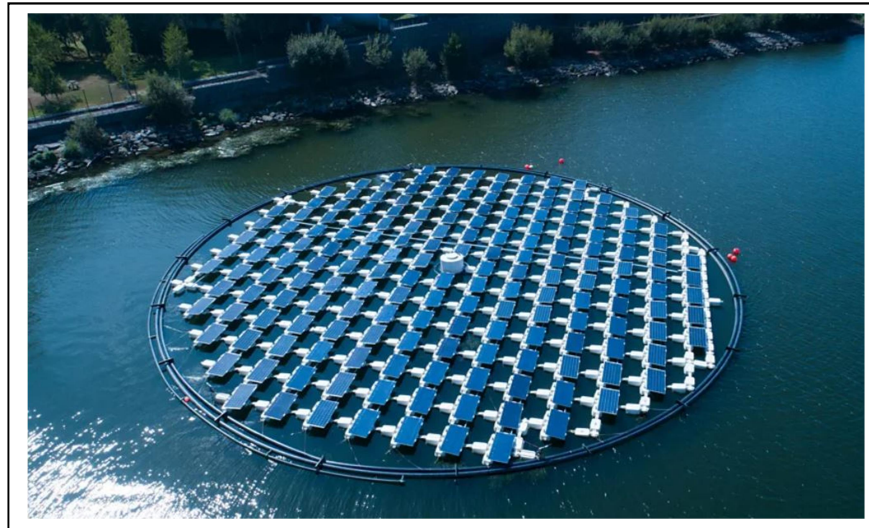
Esempi di impianti fotovoltaici galleggianti nelle figure sottostanti
